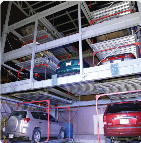
• Sistema Tablero en Instalaciones de Teletica Canal 7, Costa Rica
